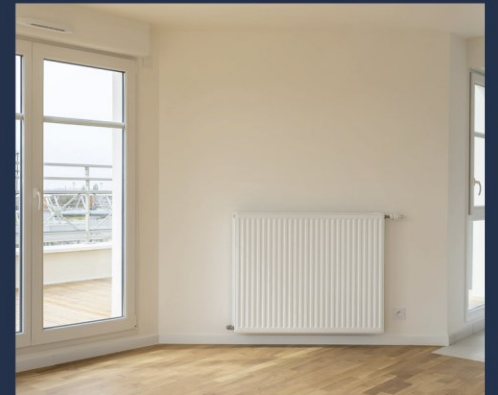
Chauffage collectif par pompes à chaleurs collectives et radiateurs basse température.
