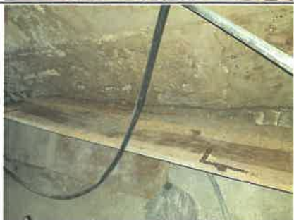
Photo n° PhTer003 Localisation : Sous sol - Cave 2 Ouvrage : Sol - Carrelage Parasite : Présence d'indices d'infestation d'autres agents de dégradation biologique du bois Indices : altérations dans le bois (présence étendue)
