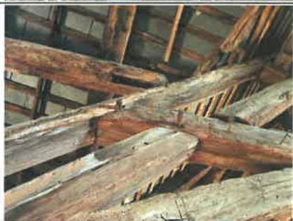
Photo n° PhTer002 Localisation : 3ème étage - Grenier 12 Ouvrage : Plafond - Charpente bois ardoise Parasite : Présence d'indices d'infestation d'autres agents de dégradation biologique du bois Indices : altérations dans le bois (présence étendue)
